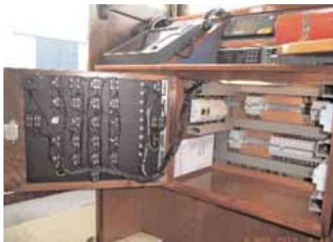
PLC scheelt ruimte in de kast.
